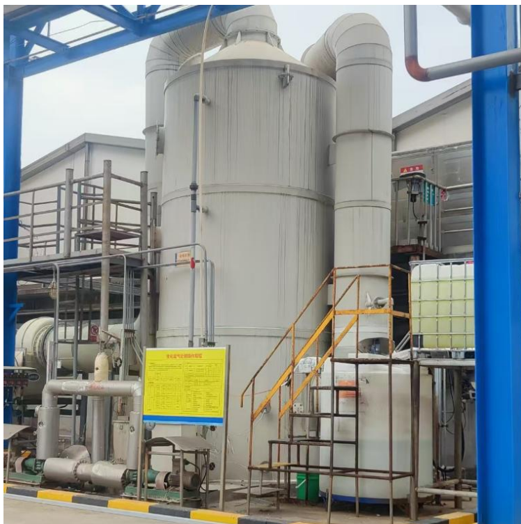
废气处理设施照片
